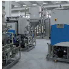
Eigene wasser- aufbereitungsanlage
