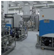
Eigen waterzuiverings- installatie
