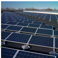
Zonnepark van 1.600 kWp
